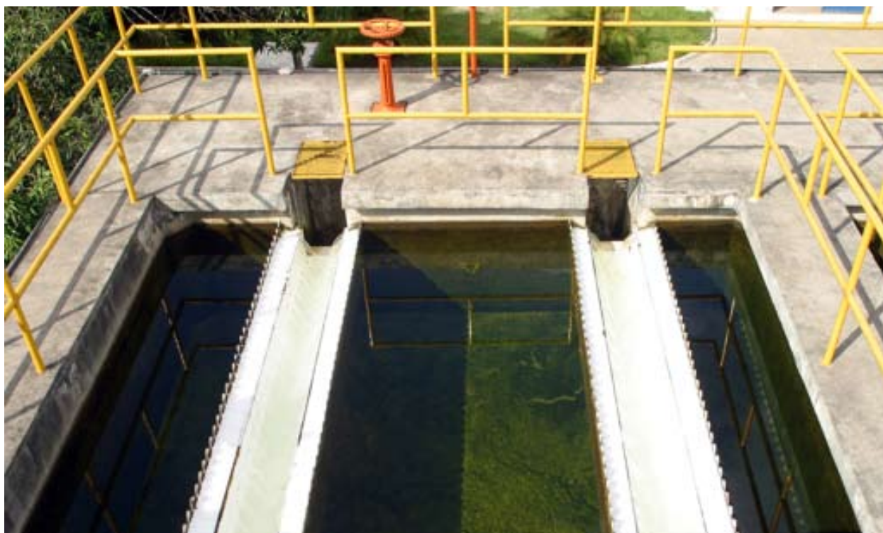
Centro de tratamento de esgoto
