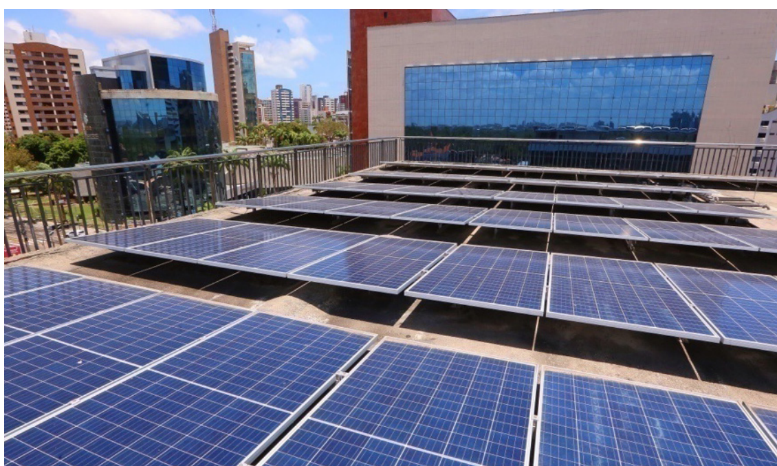
Figura 8 - Painéis solares instalados no Anexo 3 da Alece
