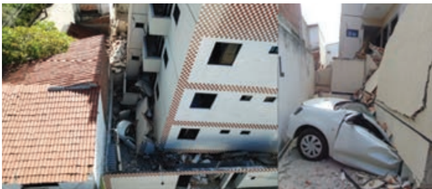
Figura 43: imóveis periciados após ocorrência de desabamento.
