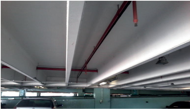
Figura 04 – Sistema de sprinklers em shopping center
