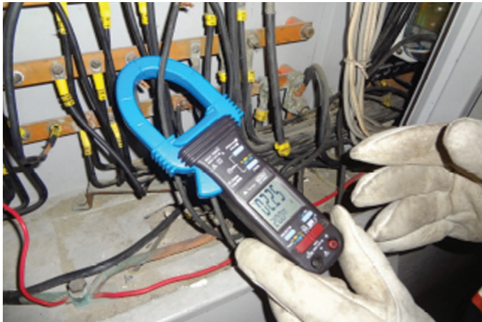
Figura 44: medição da corrente elétrica por meio de alicate amperímetro.
