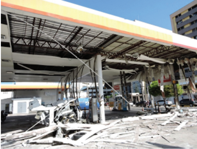
Figura 41: posto de combustível periciado após explosão de cilindro de GNV.
