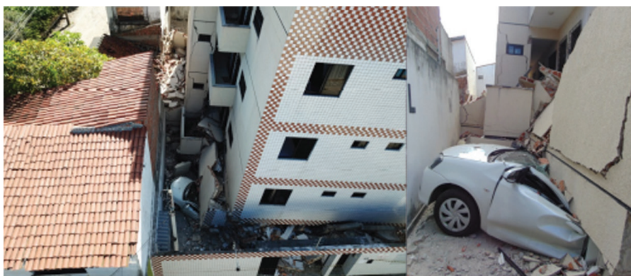
Figura 43: imóveis periciados após ocorrência de desabamento.
