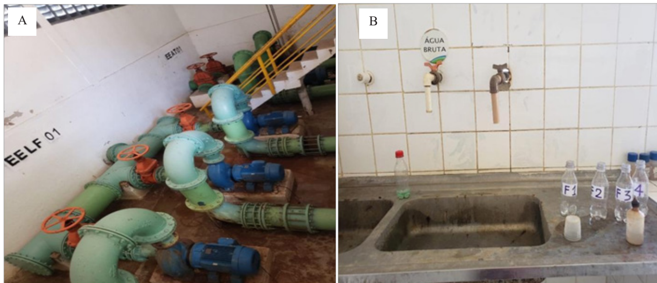
Figura 12 – A-Estação Elevatória de Lavagem de Filtro – EELF e Estação Elevatória de Água Tratada–EEAT; B- coleta e análise da água bruta e tratada.
