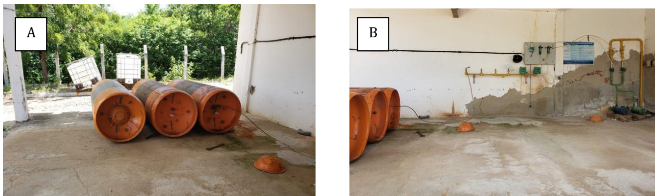
Figura 11 – A - tubos de cloro gasoso utilizados para eliminar as bactérias da água; B- tubos e sistema de tratamento.
