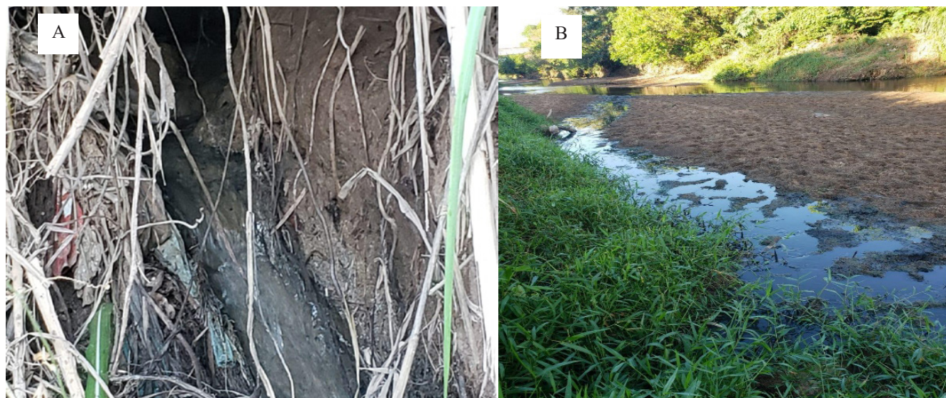
Figura 30 A e B - Esgoto saindo da manilha, localizada logo abaixo do calçadão, no Polo de Lazer de Aracoiaba, indo em direção ao Rio Aracoiaba
